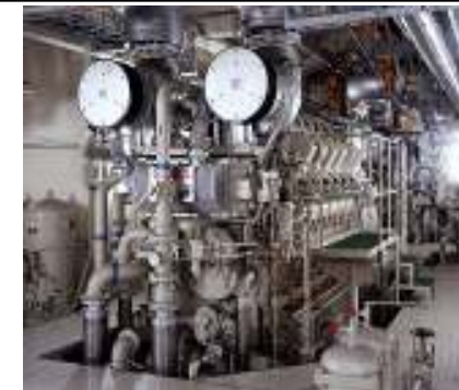
非常用エンジン(室内型)
