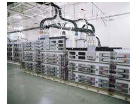
シール蓄電池
